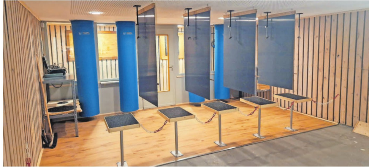
So sehen die neuen Kellerräume mit der Lüftungsanlage aus, die für frische Luft auf den 25- und 50-Meter-Ständen sorgt.
